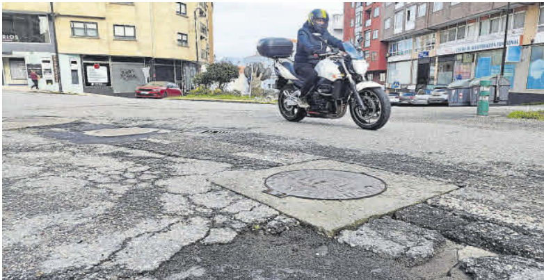
Un motorista pasando por Pedra Alta, con el entorno de las alcantarillas deteriorado. | Santos Álvarez
